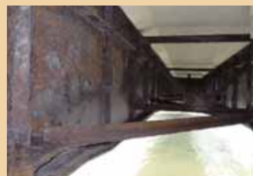
未点検の橋梁桁間では、環境により腐食が進行している場合があります。
