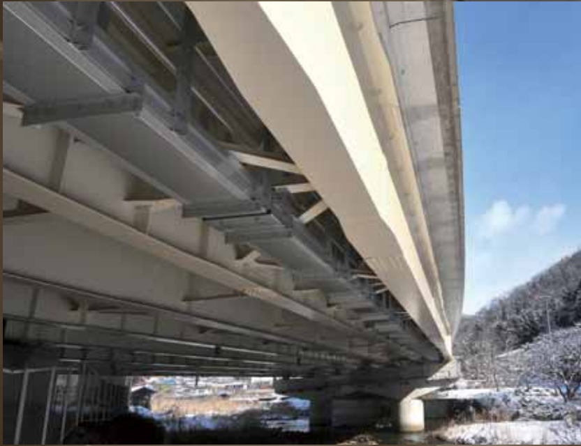
下熊谷橋 施主：西日本高速道路株式会社 場所：岡山県新見市
