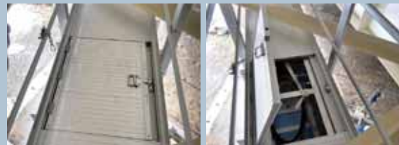
ケーブルラック点検扉
